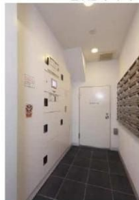
宅配ボックス
